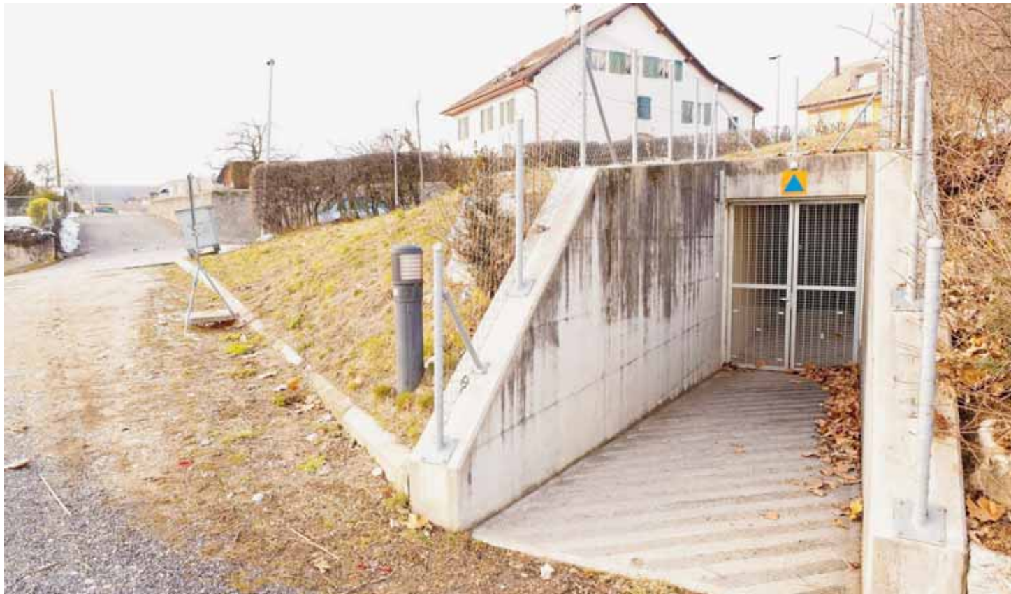
L'abri de la protection civile qui se trouve sous le belvédère peut contenir 70 personnes en cas d'urgence. Pour les besoins de l'aide aux requérants d'asile, il s'ouvrira à une cinquantaine d'hommes durant une année au moins. En 2012, les demandes d'asile ont augmenté de 45%. GLENN MICHEL
